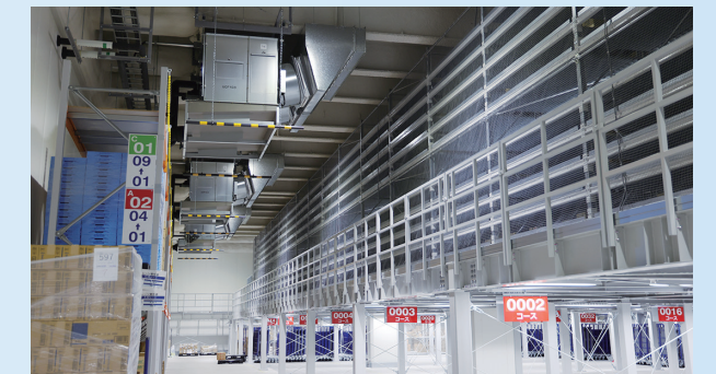
自動ケースシャトルラック
