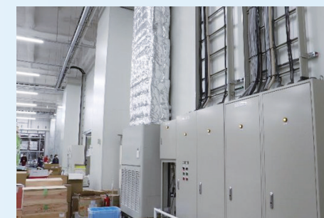
温湿度制御盤
